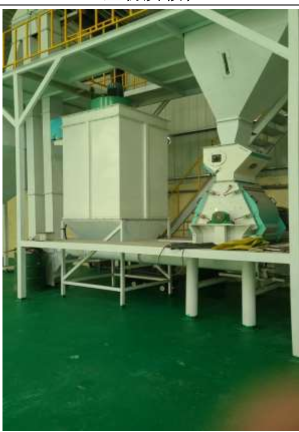
打粉废气布袋除尘器
