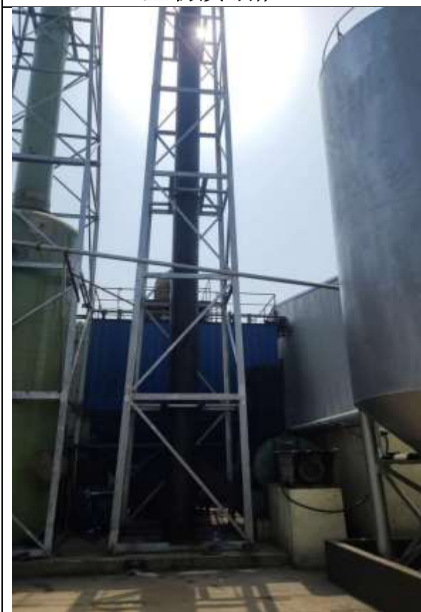
生物质锅炉 35m 排气筒 (H1)
